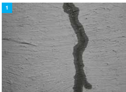
Aktywny przeciek w miejscu wystąpienia rysy w podłożu.
